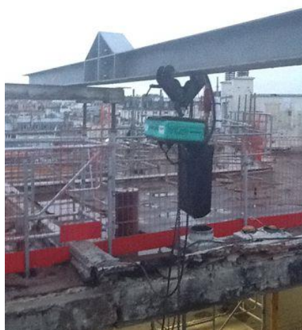
Installation sur fer avec un palan électrique à chaîne
